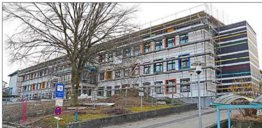
Ein Foto der Arbeiten an der Grund- und Mittelschule aus Anfang 2024: Die Generalsanierung beschäftigte den Schulverband jahrelang.
