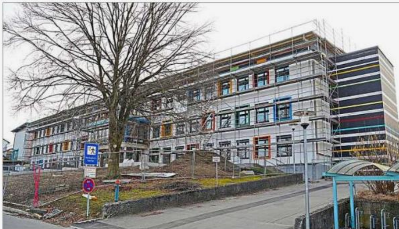
Im Außenbereich der Tanner Grund- und Mittelschule ruhen die Arbeiten über die Wintermonate. Die Fassade ist an den Fenstern farblich dezent gestaltet worden; gleiches gilt für die Einfassung der Fluchtterasse rechts. In den nächsten Tagen kann das Gerüst abgebaut werden. – Fotos: Gilg
