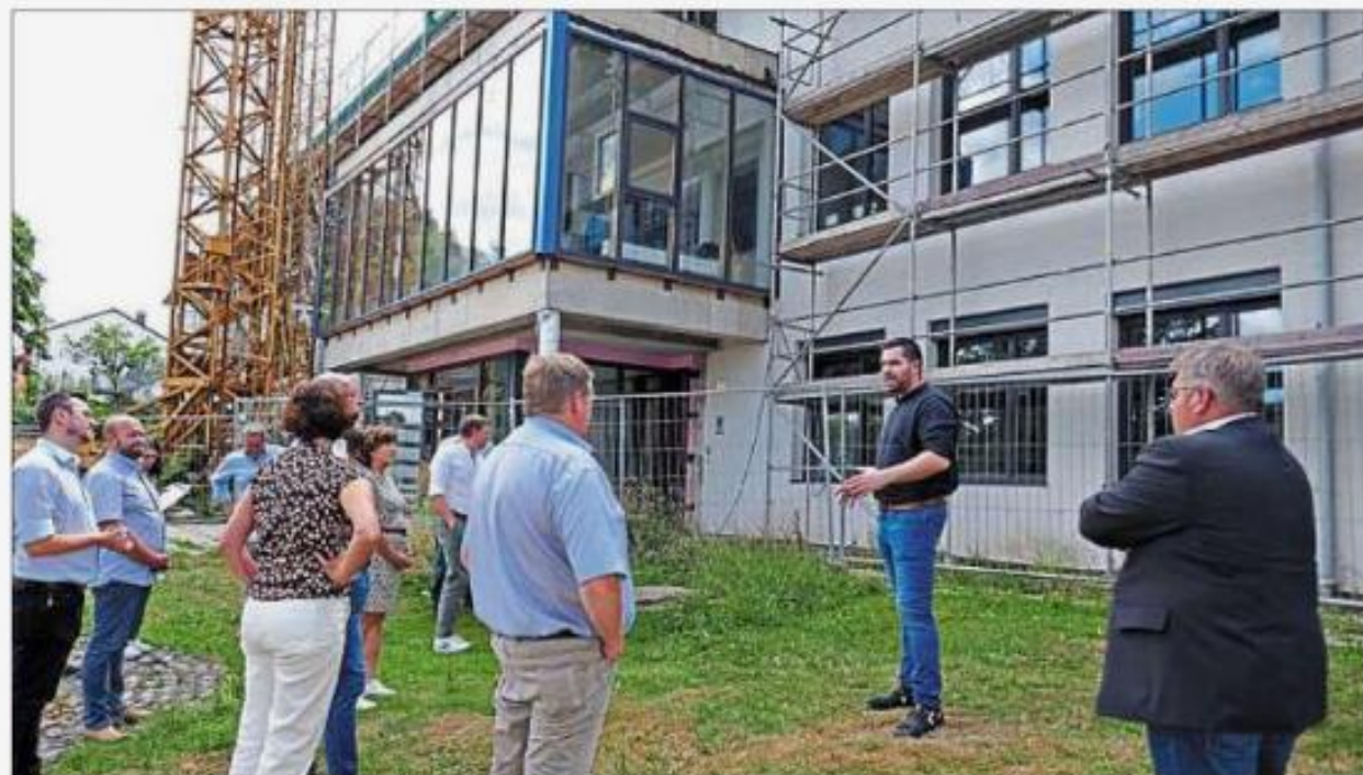
Was außen noch alles zu erledigen ist, erläutert Projektleiter Dominik Bielmeier (2. v. rechts). Insbesondere fehlt der Fassadenanstrich im rechten Teil des Gebäudes, wo gerade Bauabschnitt 1 läuft. Der Mehrzweckraum über der Pausenhalle mit dem großen Panoramafenster ist derzeit das provisorische Lehrerzimmer.
