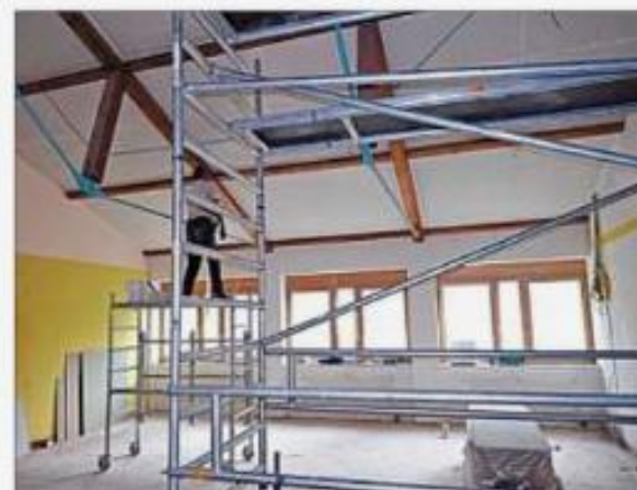
Die Arbeiten an den Decken – so wie hier in einem Klassenzimmer – sind fast fertig.
