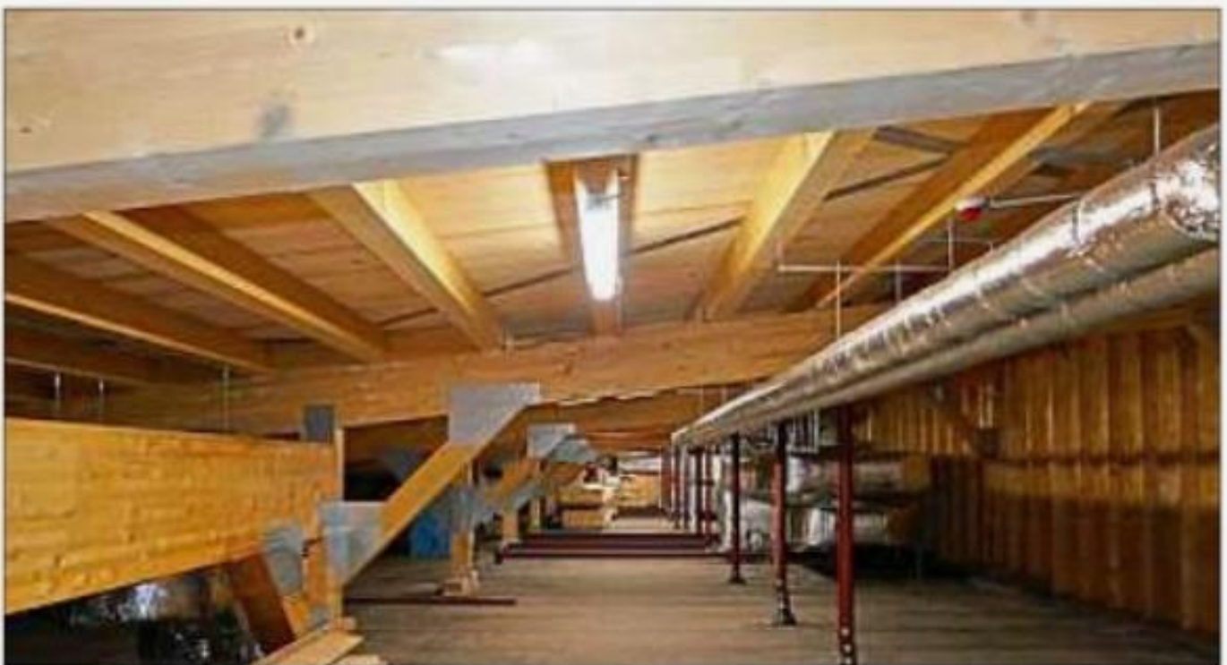
Der Dachstuhl wurde komplett erneuert. Rechts verläuft ein Rohr der Lüftungsanlage, bestehend aus drei Geräten, die hier oben untergebracht sind.
